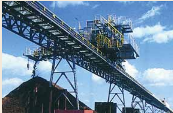
鉱石運搬コンベア： 荷下ろしが終わった鉱石等を、全長2.4kmに及ぶコンベアで工場まで運びます。
