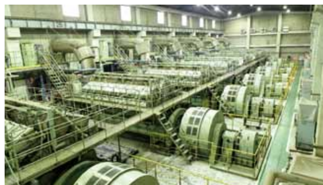
自家発電設備
