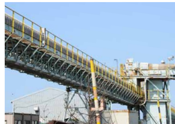
鉱石運搬コンベア：荷下ろしが終わった鉱石等を、全長2.4kmに及ぶコンベアで工場まで運びます。
