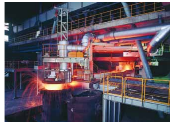
フェロニッケル製錬電気炉 ：世界最大級の電気炉であり、鉱石等を電気抵抗熱で溶かし、フェロニッケルを製錬します。
