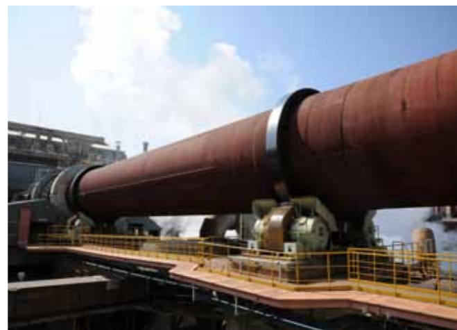
ロータリーキルン ：全長100mを超える煅焼設備であり、乾燥した鉱石等を約1,000度まで熱し、熱処理します。
