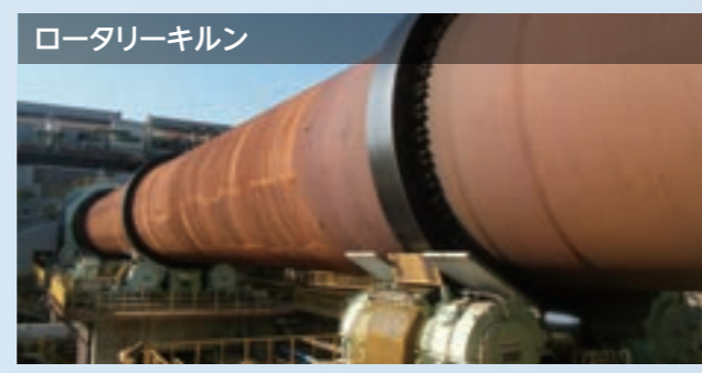
全長100mを超える煏焼設備であり、乾燥した鉱石等を約1,000度まで熱し、熱処理します。
