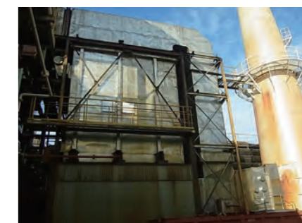
自家発電施設からの排熱を活用しているボイラー
