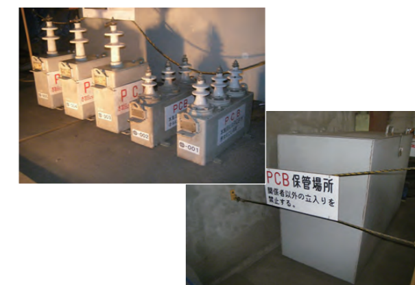
PCBの保管状況
