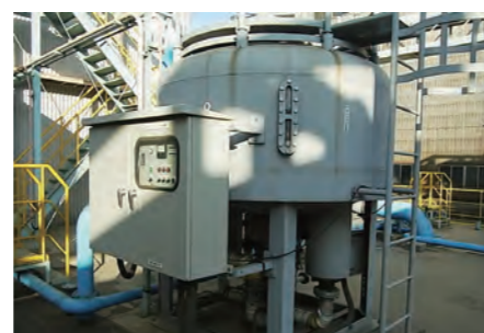
循環水専用フィルター式濾過器
