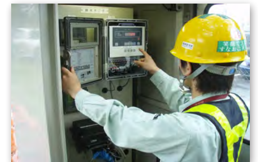
排水モニターによる水質確認
