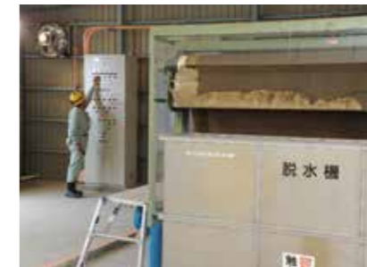
溜まった汚泥は脱水して鉱石に混ぜ全量再利用
