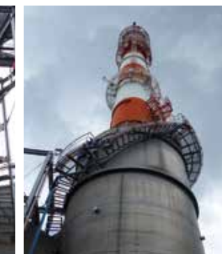
脱硫除塵装置
