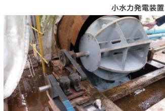
小水力発電装置
