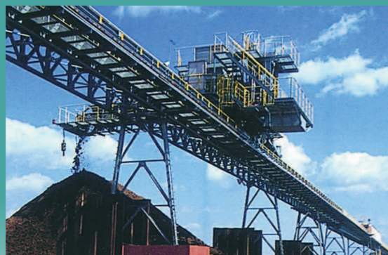
鉱石運搬コンベア：荷下ろしが終わった鉱石等を、全長2.4kmに及ぶコンベアで工場まで運びます。
