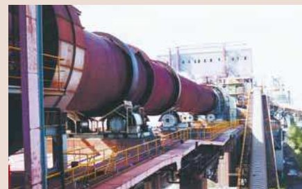
ロータリーキルン：全長100mを超える煨焼設備であり、乾燥した鉬石等を約1,000度まで熱し、熱処理します。
