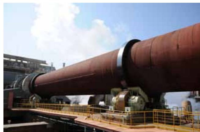
ロータリーキルン：全長100mを超える焙焼設備であり、乾燥した鉱石等を約1,000度まで熱し、熱処理します。
