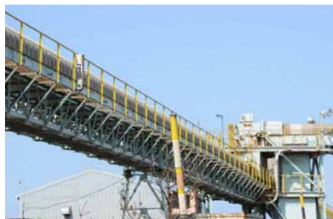
鉱石運搬コンベア：荷下ろしが終わった鉱石等を、全長2.4kmに及びコンベアで工場まで運びます。
