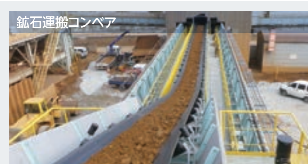
荷下ろしが終わった鉱石等を、総延長2.4kmに及ぶコンベアで工場まで運びます。
